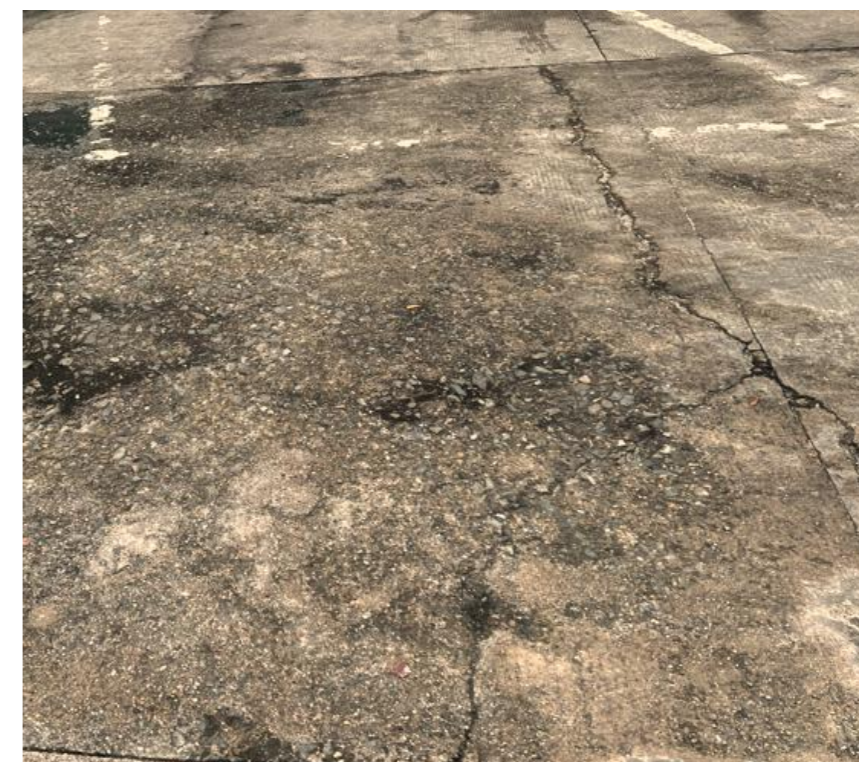
定南服务区广场水泥混凝土面板破损
