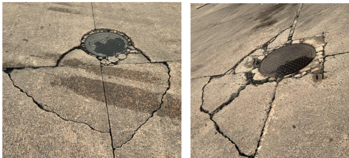
定南服务区井盖破损
