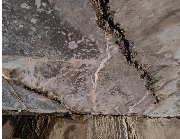
行车道侧盖板板底纵向贯通裂缝
