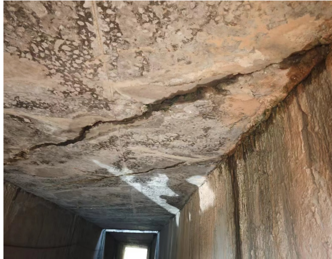
行车道侧盖板板底纵向贯通裂缝
