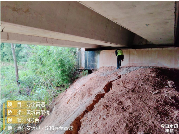
图 3.1.7 桥台盖梁脱空
