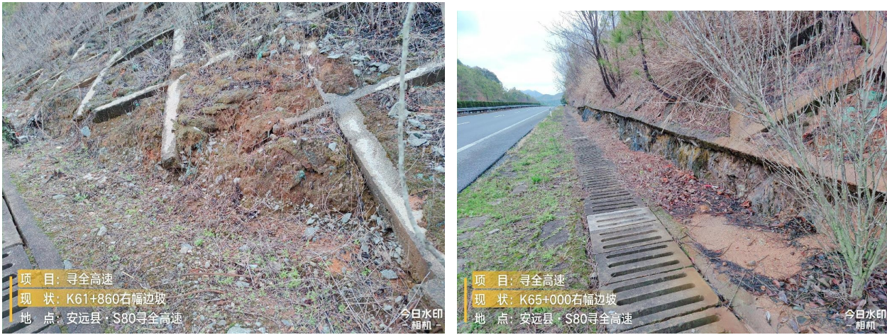
图 3.1.9 框格梁基础脱空
