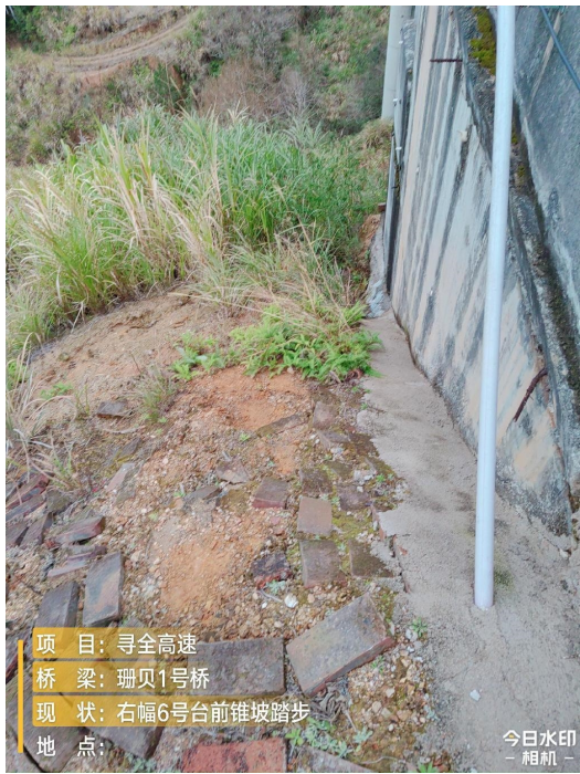
图 3.1.4 桥梁未设置检修踏步
