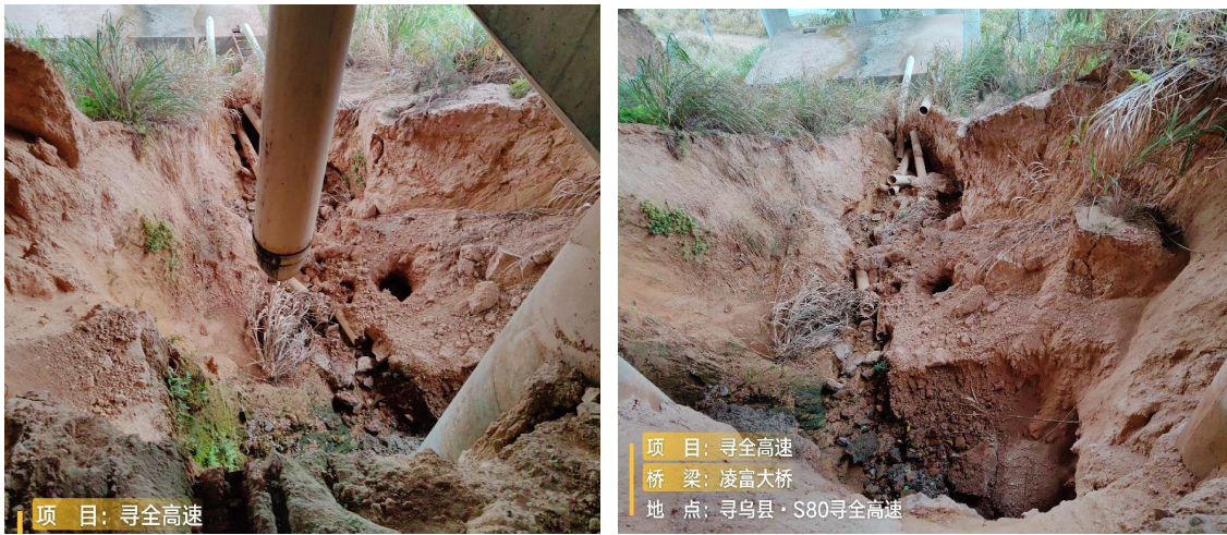
图 3.1.5 集中排水管脱落、桥下冲沟
