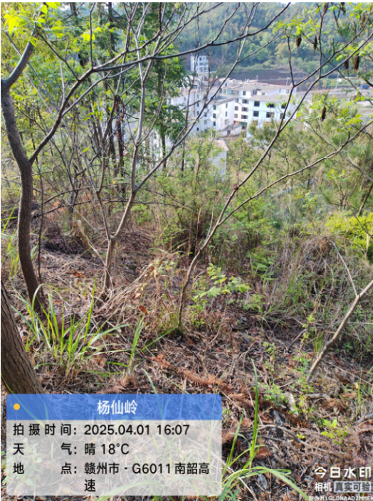
未设边坡检查步道
