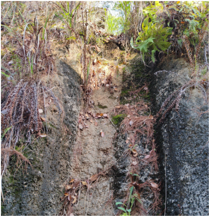
坡面急流槽毁坏
