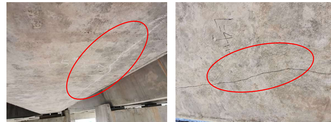
图 3.2.7 主梁纵向裂缝
