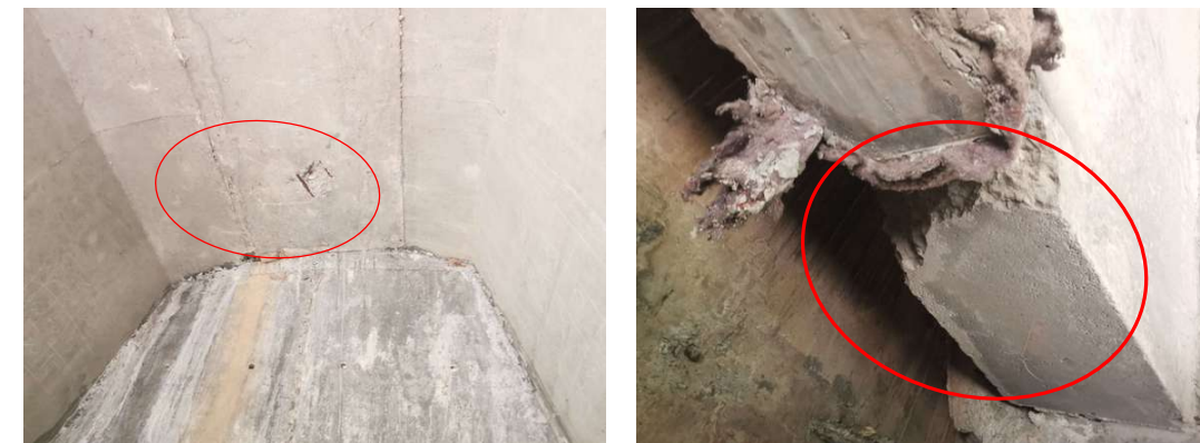
图 3.2.8 湿接缝剥落、露筋
