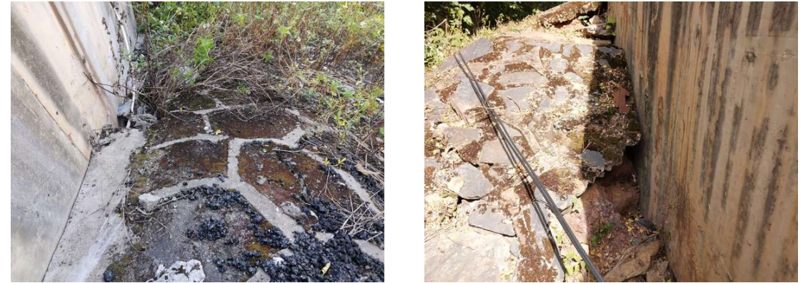
图 3.3.7 锥坡下沉、破损
