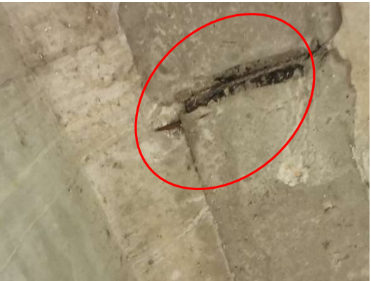
图 3.2.5 主梁锈胀露筋
