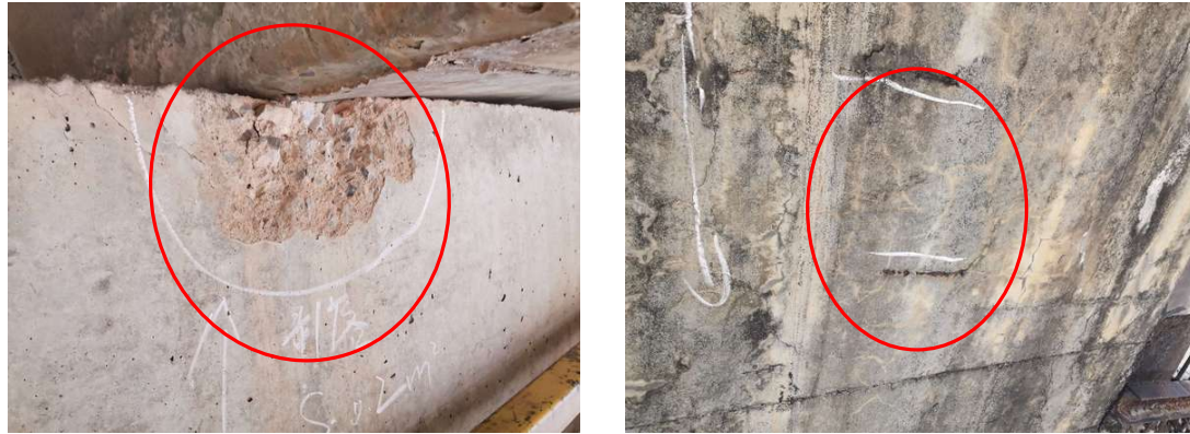
图 3.3.1 桥墩锈胀露筋
