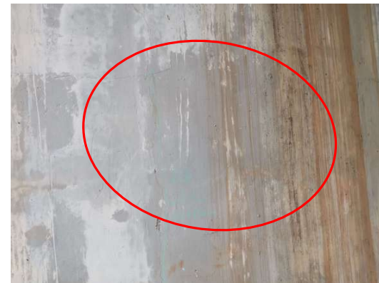
图 3.3.6 桥台竖向裂缝
