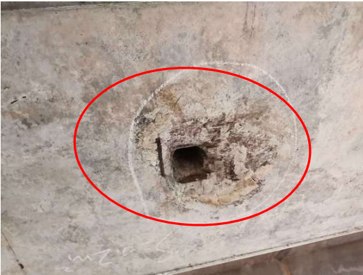
图 3.2.3 主梁剥落、露筋
