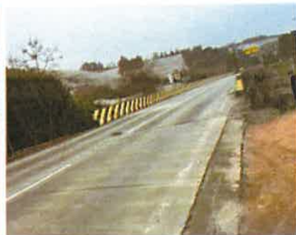
图3 桥头铺装破碎、跳车
