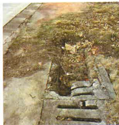
图5 水沟盖板损坏
